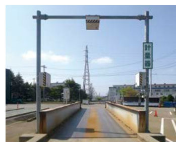
射水RC 80tトラックスケール
